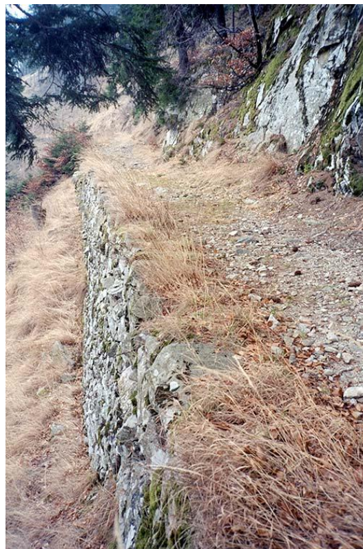
Immagine 31: Muri di sostegno a valle e scarpata in roccia a monte lungo la salita per Braggio (© IVS).
