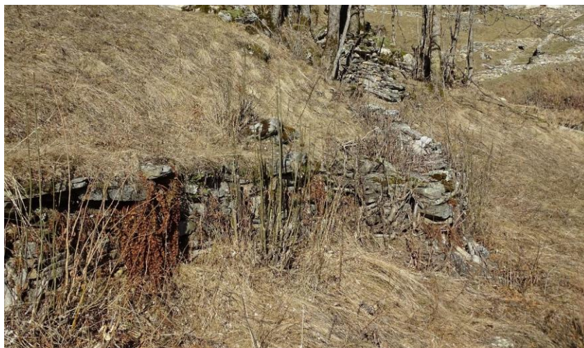
Foto 7: muri a secco da sistemare in zona Scata a Rossa
